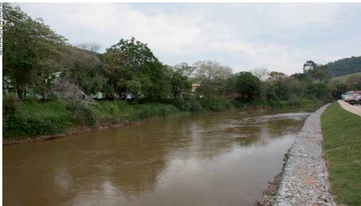
Obras de desassoreamento nos rios Paraitinga, Chapéu e Turvo serão feitas em 18 meses
