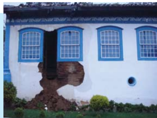
Estragos no prédio centenário: melhor prevenir que remediar
