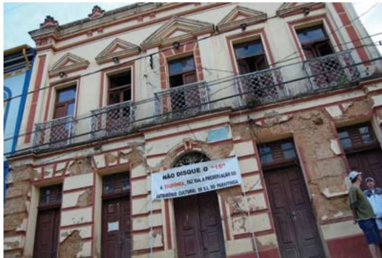
Prédio representativo da história da cidade à espera do apoio empresarial para sua completa recuperação
