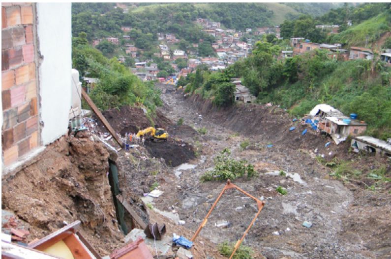
Deslizamento de terra
